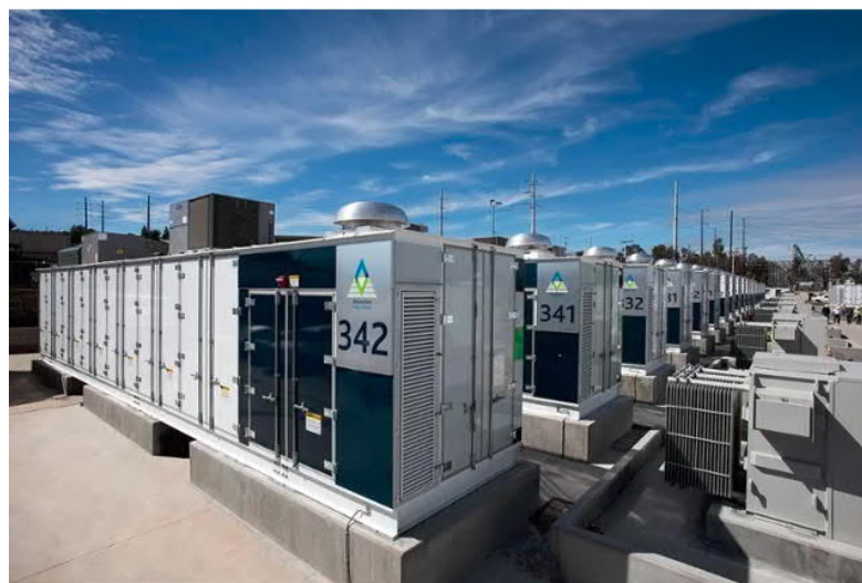
Figura 5.1 – Instalação dos sistema de armazenamento 30MW/120MWh, Escondido, Califórnia – EUA - Fonte: FLUENCE, 2018
